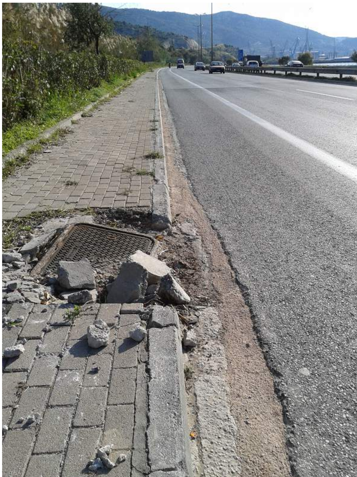
Σημεία 10 – 11: Η κατάσταση της Εθνικής Οδού στα σημεία 10 – 11, στις 3 Δεκεμβρίου 2015 στο ύψος της Λίμνης Κουμουνδούρου. Η εξωτερική εμφάνιση των φρεατίων ομβρίων δεν φαίνεται να είναι λειτουργική, ενώ υπάρχουν και κατεστραμμένα ή σκεπασμένα από φερτά υλικά φρεάτια.
