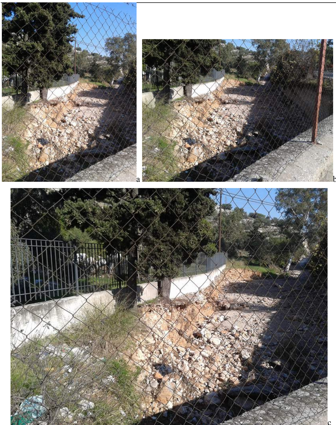
Σημείο 6: 6 Δεκεμβρίου 2015. Οι φωτογραφίες, δείχνουν την διάβρωση των πρανών του χειμάρρου στο ρεύμα προς Ελευσίνα, στο ύψος του αρχαιολογικού χώρου της Αφαίας. Η διάβρωση των πρανών είναι σημαντική και ο κίνδυνος για τον αρχαιολογικό χώρο ορατός.
