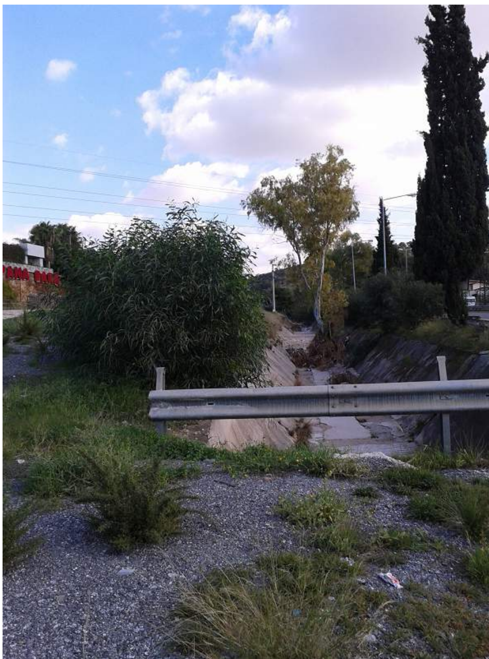
Σημείο 8: Η κατάσταση του ρέματος στο σημείο 8 στις 3 Δεκεμβρίου 2015 στο ύψος του Corasorana. Το ρεματάκι είναι γεμάτο φερτά υλικά. Η υπερχειλίση του νερού διαβρώνει το κομμάτι του αρχαιολογικού χώρου της “Ιεράς Οδού” που είναι ορατό στα αριστερά της φωτογραφίας.
